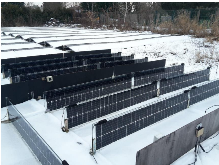
Abbildung 9: Testgelände in Forst nach Schneefall, vgl. auch Abb. 2 . Für das im Vordergrund sichtbare, senkrecht ausgerichtete Bifazial-System (Ost/West) sind die Bedingungen optimal: schneeweiße Reflektor-Flächen mit hohen Albedo-Werten und keinerlei Modul-Verschattung. Dagegen ist die Ost/West-orientierte Standard-Anlage (im Hintergrund) nahezu vollständig durch Schneebedeckung verschattet.
