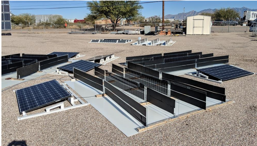
Abbildung 1: Testfeld in Tucson, Arizona (USA) mit unterschiedlich ausgerichteten PV-Teilanlagen mit senkrecht installierten Bifazial-Modulen, sowie konventionell flach aufgeständerten Monofazial-Modulen. Die senkrecht installierten Module sind zur Nachbildung eines größeren Systems mit Dummy-Modulen umgeben, um wirklichkeitsnahe Verschattungsszenarien im Betrieb der Anlagen zu realisieren.
