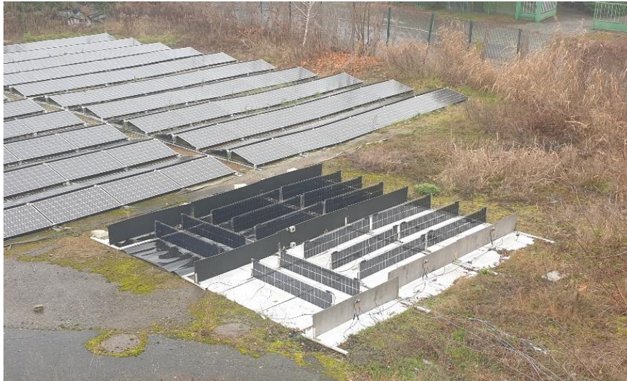
Abbildung 2: Testfeld in Forst, Lausitz mit unterschiedlich ausgerichteten PV-Teilanlagen mit senkrecht installierten Bifazial-Modulen (in Ost/West bzw. Süd/Nord-Orientierung), sowie einer in Ost/West-Richtung installierten PV-Anlage mit konventionellen flach aufgeständerten (Anstellwinkel: 10°) Monofazial-Modulen. Die senkrecht installierten Module sind zur Nachbildung eines größeren Systems mit Dummy-Modulen umgeben. Außerdem sind die unterschiedlich reflektierenden Albedo-Untergründe (weiß/schwarz) zu erkennen.
